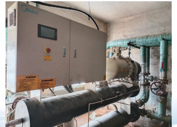
地源热泵技术节能降耗
